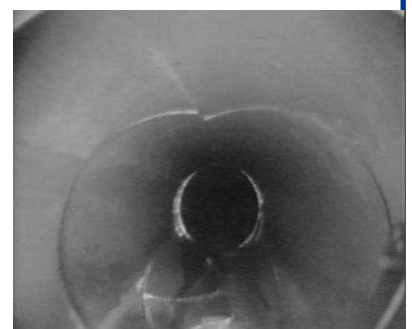
Avería de tubo localizada
